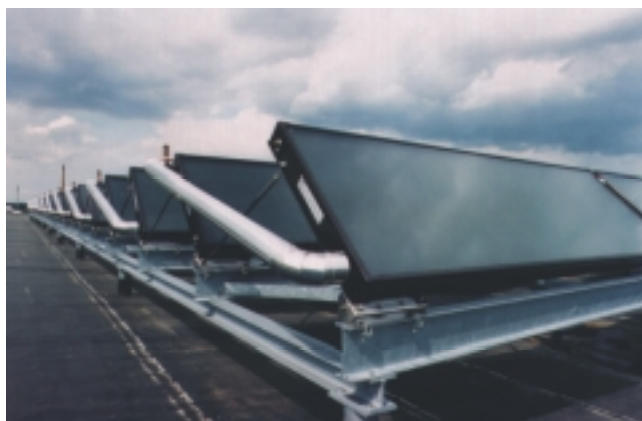
Abb. 1 Typische Tragkonstruktion für eine große Solaranlage auf dem Flachdach eines Wohngebäudes, Quelle: Tilman Schibel (Viessmann)
